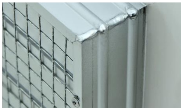
Trafo Ventilasjonsrist sett fra baksiden
